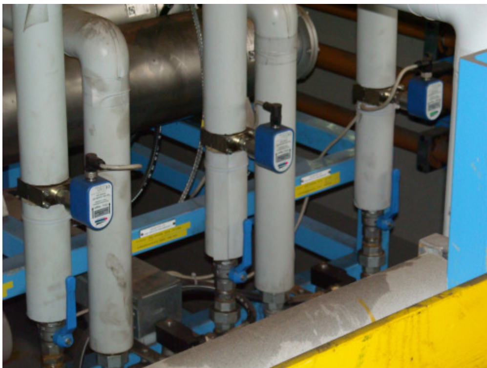
Abbildung 4: Überwachung einer Einfettölanlage mit Volumenströmsensoren fluid-Check ® und serv-Clip ® -2 an einer Durchlaufbeizlinie
